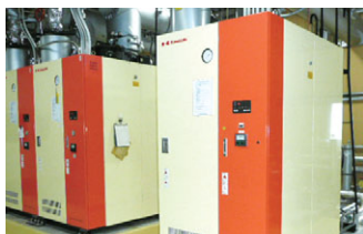
● 貫流ボイラー（油日ラボラトリーズ）
