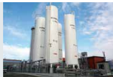
金ヶ崎工場LNG供給設備
