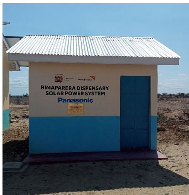
<蓄電システム>
