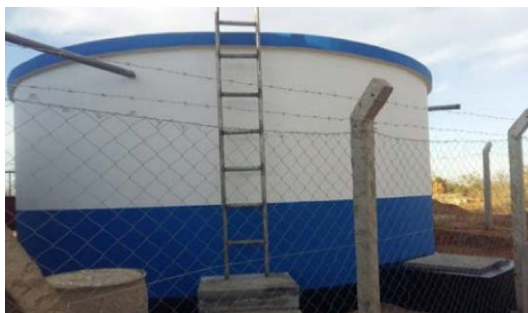
ミドイナ診療所の給水タンク 水供給設備が整備されることにより、安全で清潔な水にアクセスできるようになります
