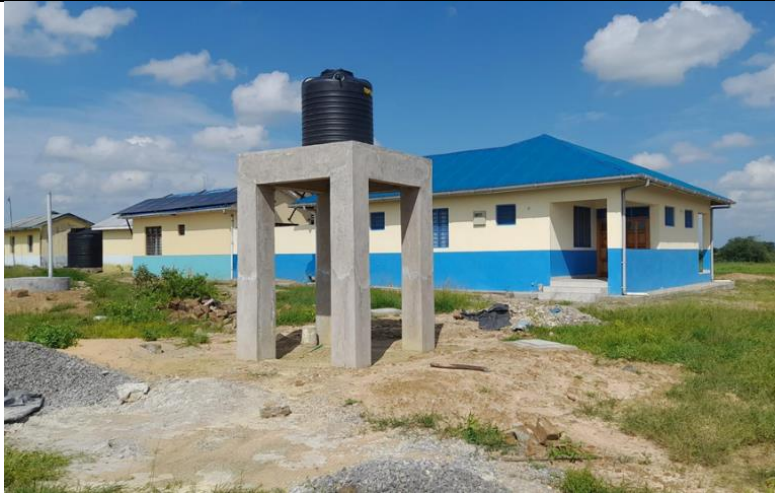
リマラペラ診療所で稼働中の給水タンク
